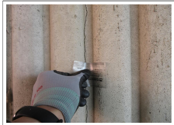
A2 구체 균열(폭:0.3mm이상)
