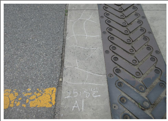
A1 신축이음 후타재 망상균열
