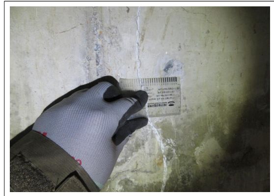
A1 흉벽 균열(폭:0.3mm이상)
