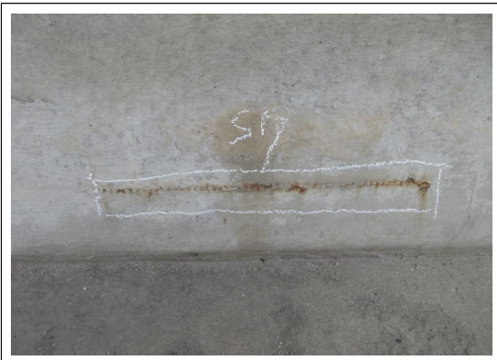
S7 방호벽 철근노출
