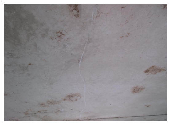
S9 바닥판하면 균열(폭:0.3mm미만)
