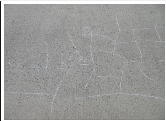
S4 교면포장 망상균열
