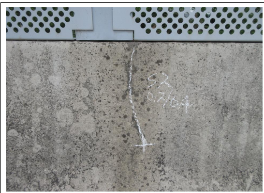
S2 방호벽 균열(폭:0.3mm미만)
