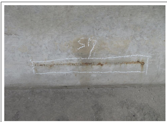
S7 방호벽 철근노출
