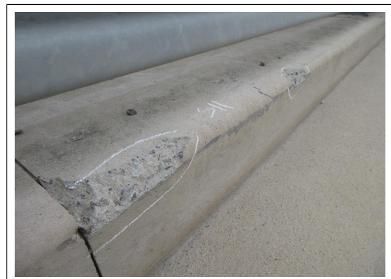
S11 중앙분리대 연석 파손
