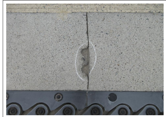
A1 신축이음 후타재 파손
