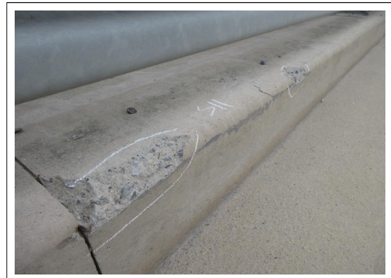
S11 중앙분리대 연석 파손
