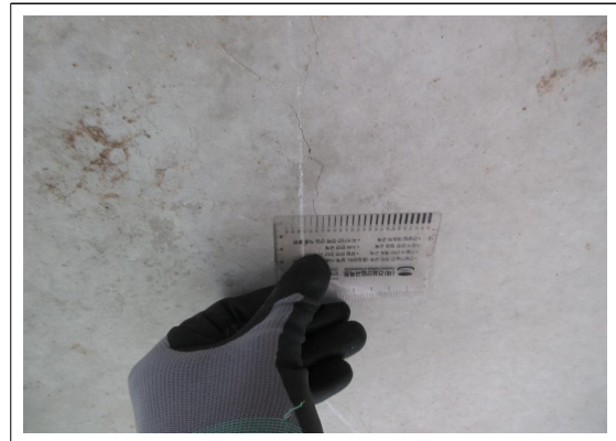
S9 바닥판하면 균열(폭:0.3mm미만)
