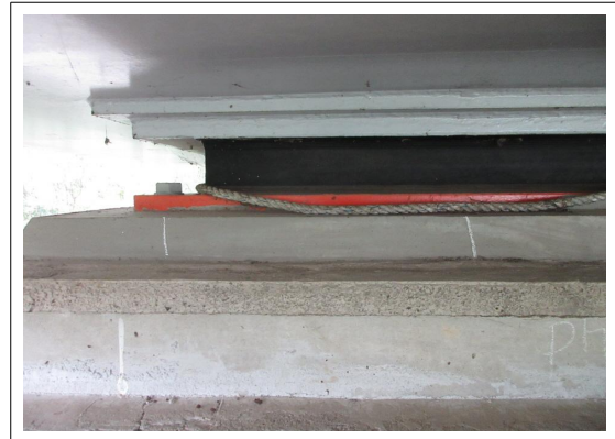
P7-Sh1 받침몰탈 균열(폭:0.3mm미만)
