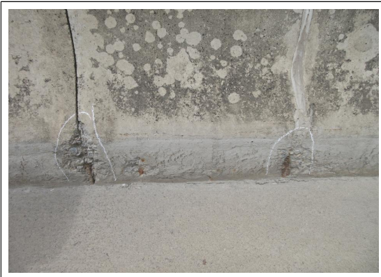
S1 방호벽 철근노출
