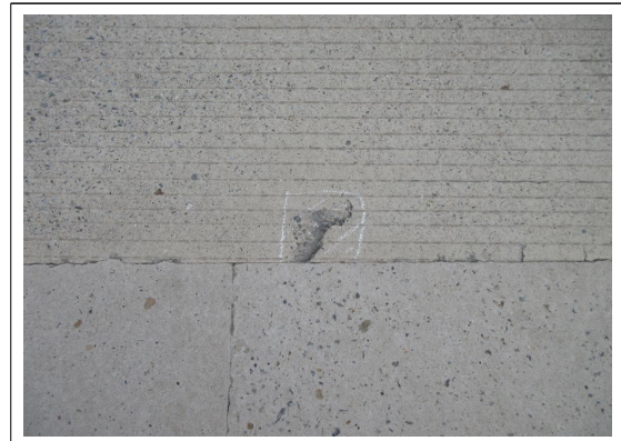
S6 교면포장 파손
