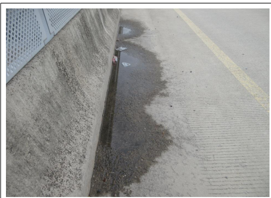
S8 교면포장 체수
