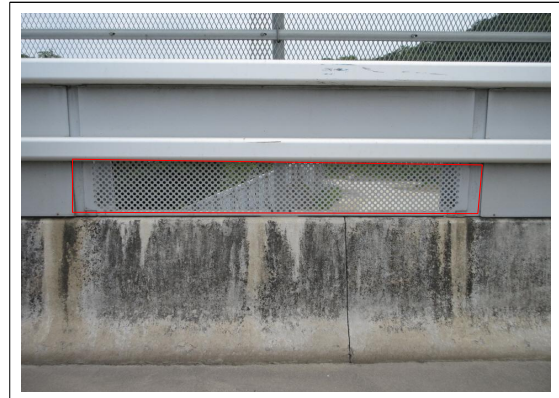
S1 난간 덮개 탈락
