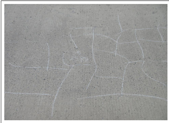
S4 교면포장 망상균열
