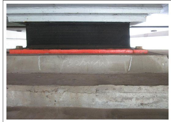
P5-Sh2 받침몰탈 균열(폭:0.3mm미만)
