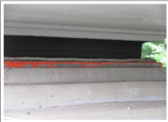
P6-Sh1 받침몰탈 균열(폭:0.3mm미만)
