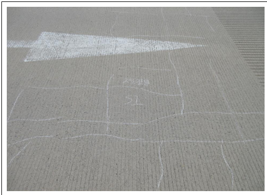
S1 교면포장 망상균열
