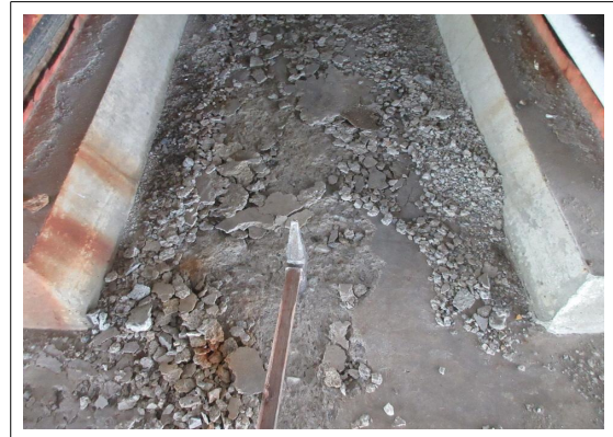
P5-Sh2 받침콘크리트 박리
