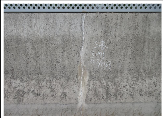
S2 방호벽 보수부 재균열(폭:0.3mm미만)
