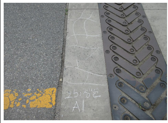
A1 신축이음 후타재 망상균열
