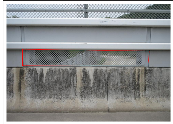
S1 난간 덮개 탈락
