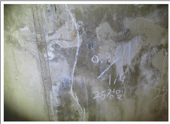
A1 흉벽 균열(폭:0.3mm이상)
