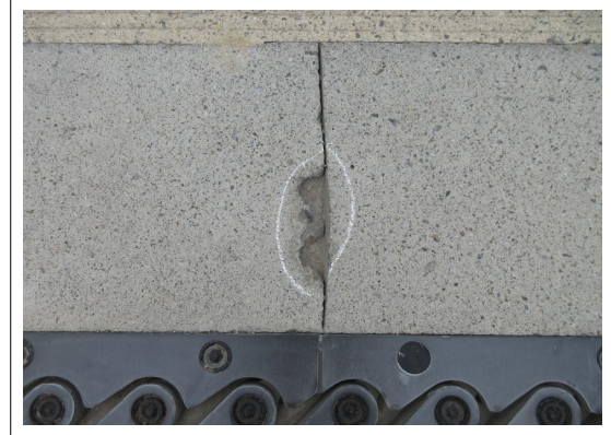
A1 신축이음 후타재 파손
