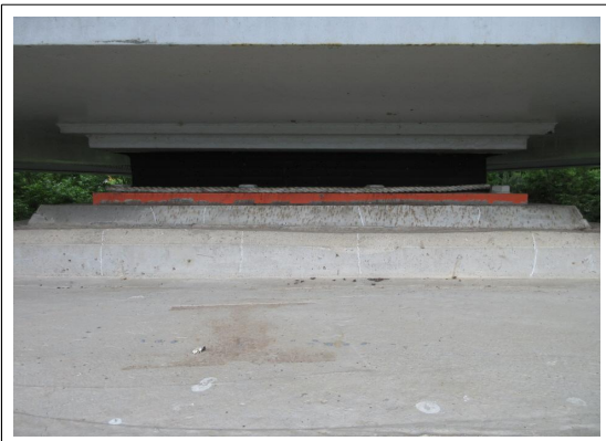
P8-Sh1 받침몰탈, Con'c 균열(폭:0.3mm미만)
