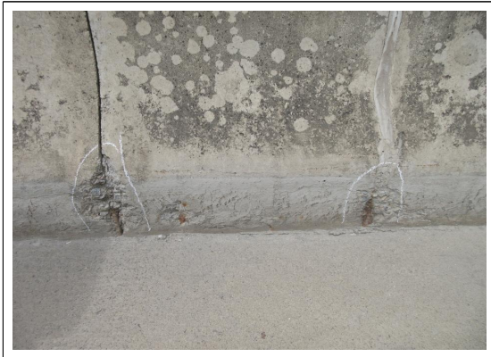
S1 방호벽 철근노출
