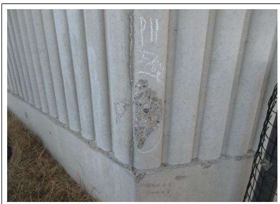
P11 기둥 파손
