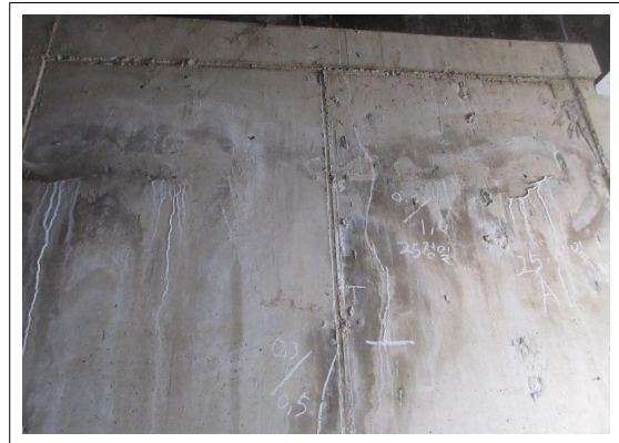
A1 흉벽 균열(폭:0.3mm이상)
