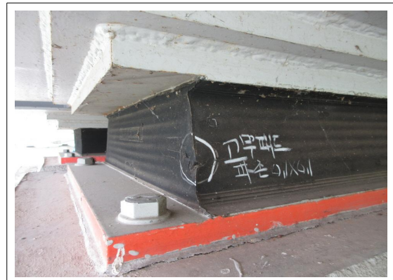
P9-Sh1 받침장치 고무패드 파손
