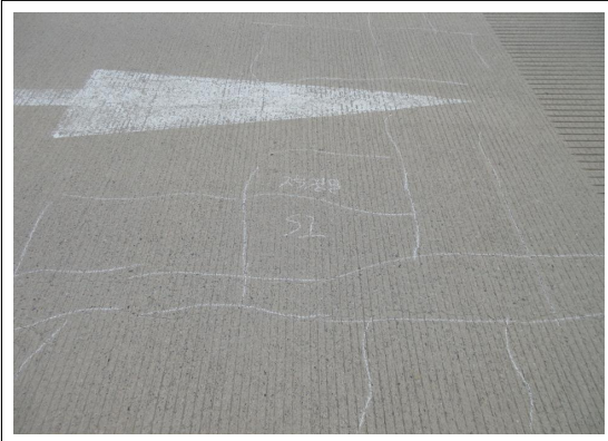
S1 교면포장 망상균열
